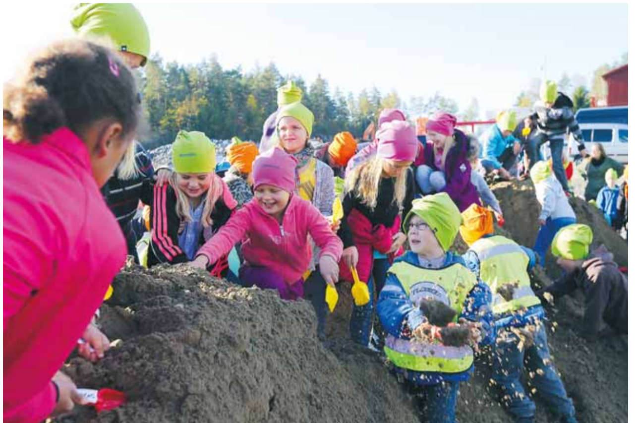
Elever från Älvängensskolan årskurs två, Hövägens förskola avdelning röda vinbäret och särskolan fick symboliskt gräva fram en skattkista när den nya skolan i Älvängen officiellt började byggas i fredags.
